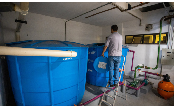
Ampliação do sistema de aproveitamento de água pluvial foi realizada nas PJs de Ceilândia, Paranoá e Brasília II, além do edifício-sede.
